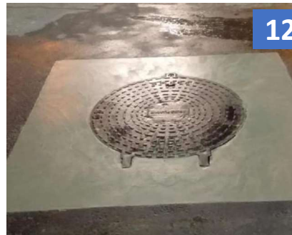
12 – ASPECTO DO RENOVAMENTO DO TAMPÃO PRONTO – APOS RETIRADA DA CHAPA DE AÇO, LIMPEZA E RECOMPOSIÇÃO DOS FUROS DEIXADOS PELOS CHUMBADORES DE FIXAÇÃO DA CHAPA DE AÇO
